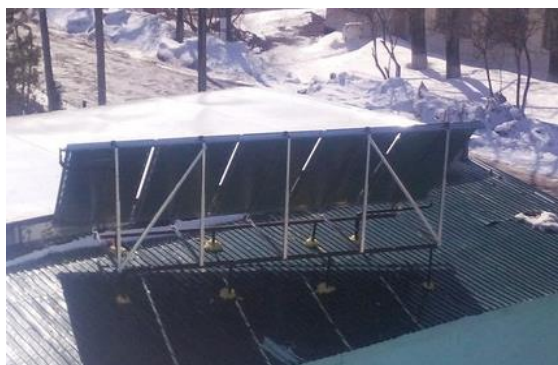
отопление теплицы в с. Арнасай
