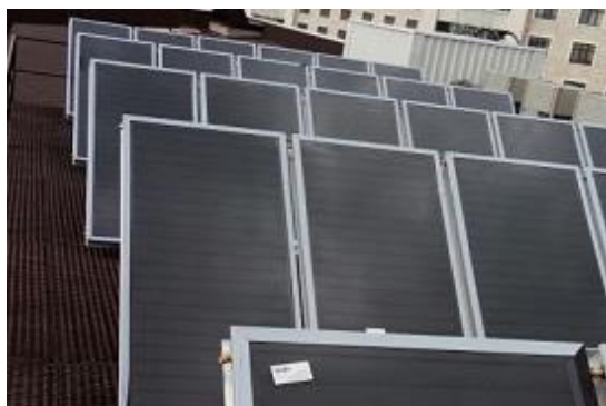
ГВС + бассейн, Спорткомплекс НУ
