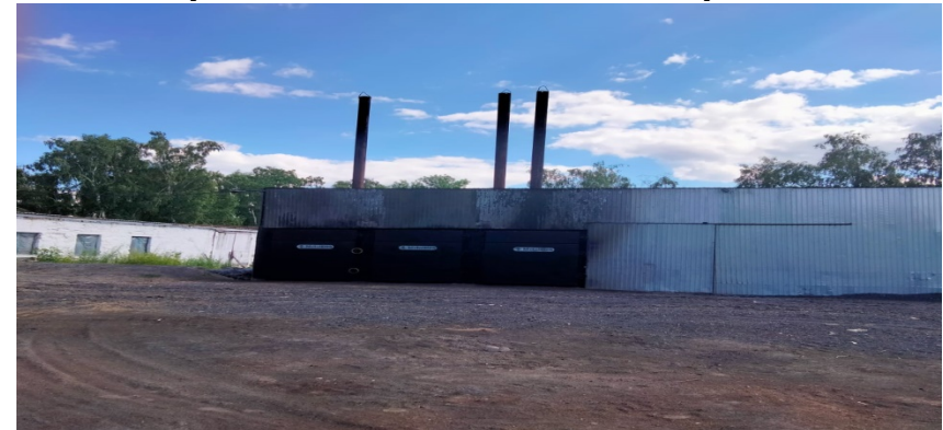
Центральная котельная, г. Сергеевка
