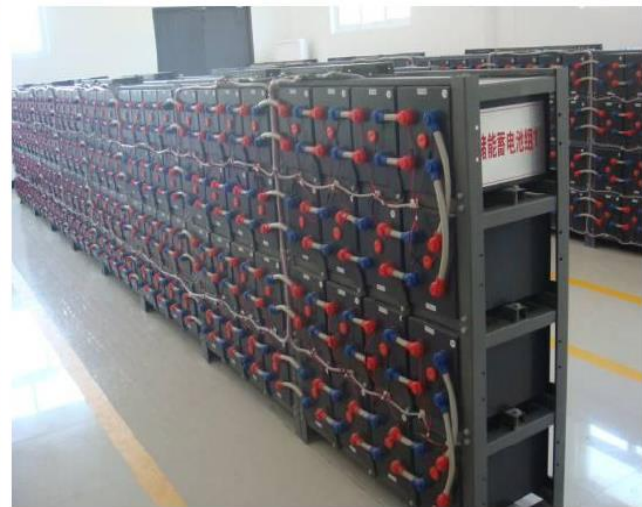
(b) 980kWh 阀控式铅酸蓄电池
