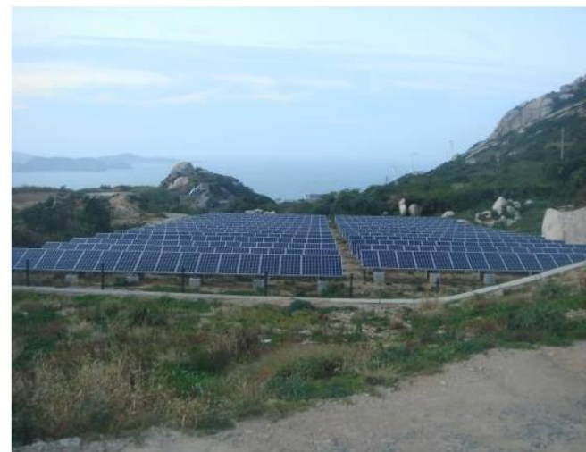
(d) 100kW 光伏电站
