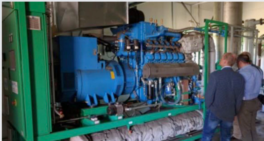
Генераторная установка синтетического газа
