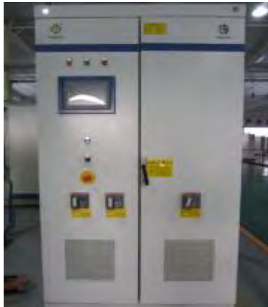
200kVA逆变器（下垂控制）
