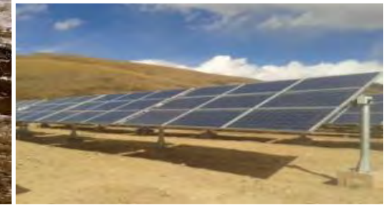
2MW平单轴+15.2MWh铅酸
